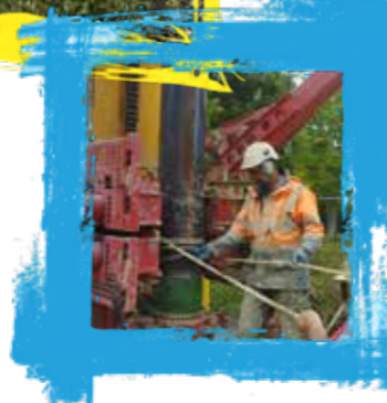
Engager la transition énergétique Installation d'ombrières photovoltaïques à Pétrus et d'un réseau de chaleur par géothermie dans le bourg.
